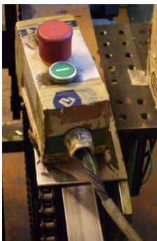
Schadhafte Leitungen oder Anschlüsse müssen umgehend erneuert werden!
